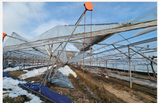
과수 재배시설 붕괴
